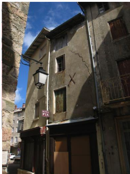
Bâtiments dégradés des parcelles 288 et 289
