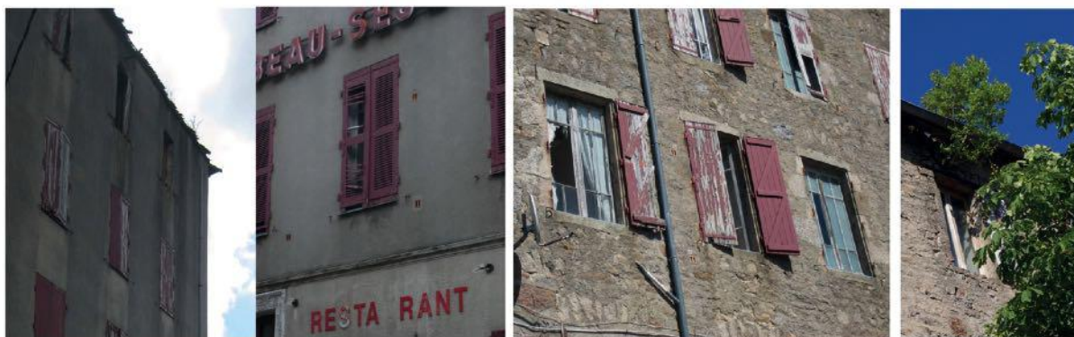
Vues montrant l'état de dégradation du bâtiment
